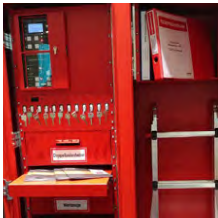
Primer požarne omare, v kateri so gasil-cem na voljo ključi, načrti objekta, požarni in evakuacijski načrt, lahko pa tudi določeni pripomočki in orodje.
