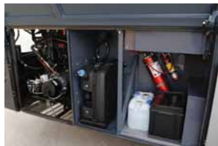
Nameščen je bil tudi sistem za gašenje požara v motornem prostoru, ki bo kmalu postal zakonsko določen.
