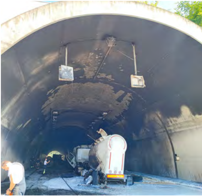
Pregled, po požaru v pokritem vkopu Malečnik, je pokazal, da je v celoti uničena elektroinstalacijska oprema, poškodovana sta tudi betonski obok in prometna oprema.
